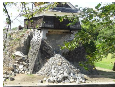
倒壊した熊本城の石垣
