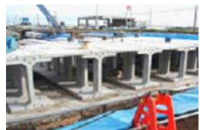
雨水貯留施設 (P.12)
